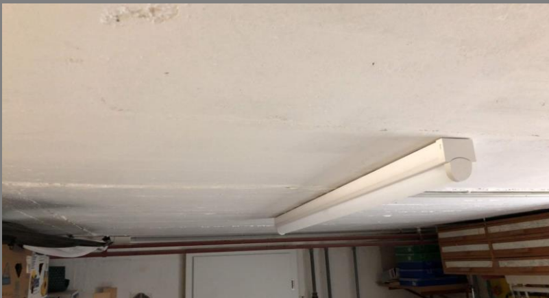
Kellerdecke teils unisoliert
