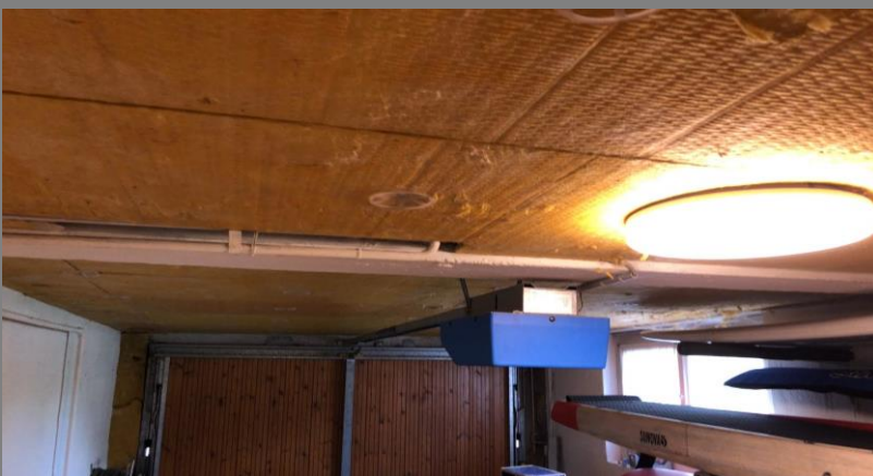
Kellerdecke teils isoliert
