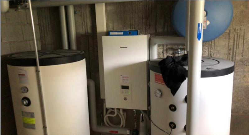
Neue Split WP mit Pufferspeicher und Warmwassererzeugung ganzjährig
